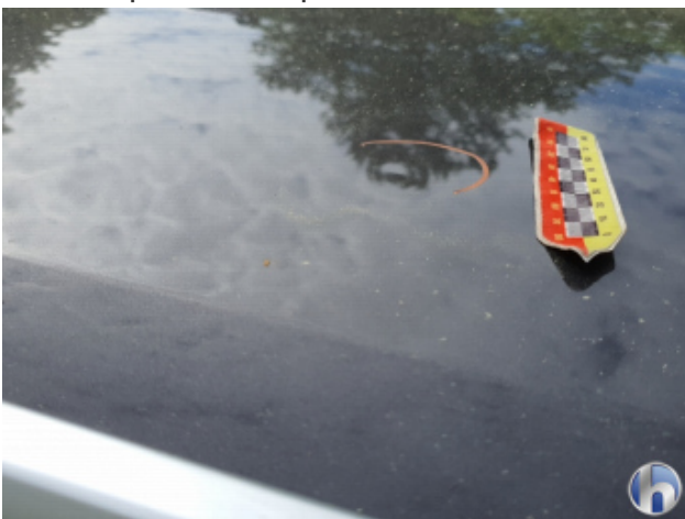
6. Dach Gebrauchsspuren - Ohne Reparatur
