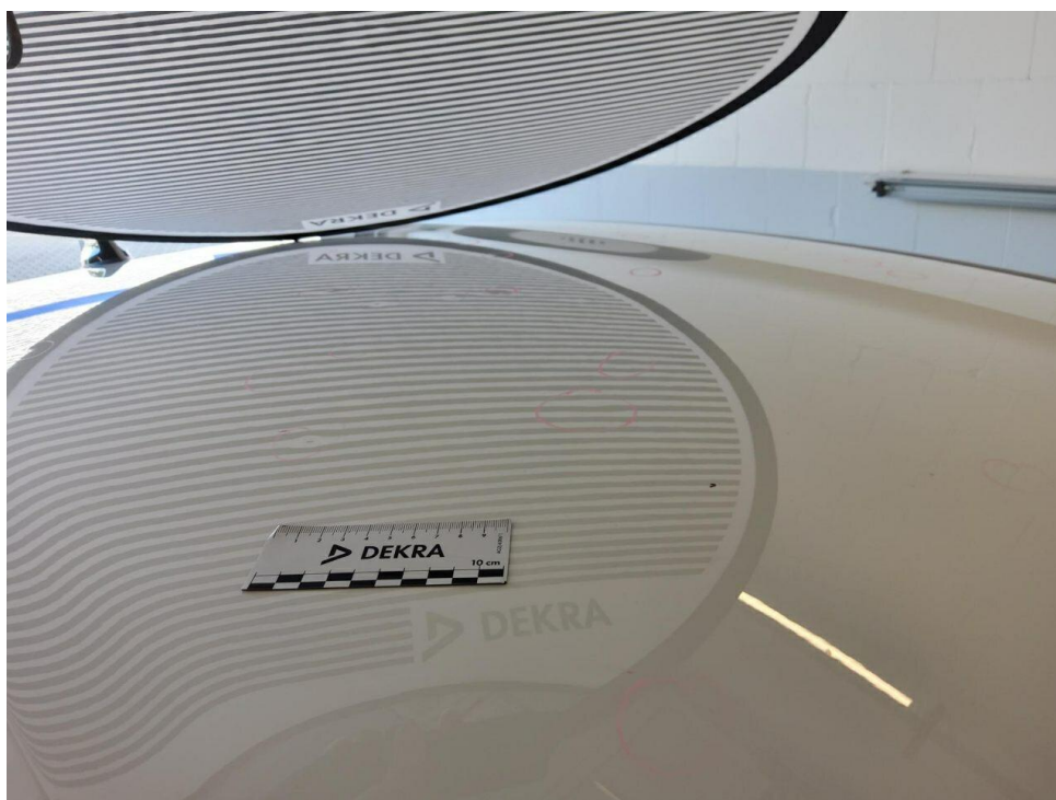
Bild 22 : Dach, mehrfach eingedellt, drücken 50 Dellen
