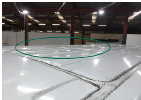
Dach / Hinten / Delle
