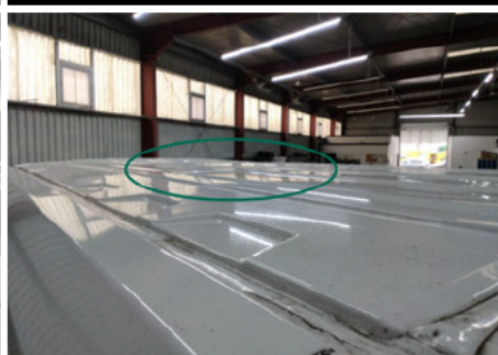
Dach / Hinten / Delle
