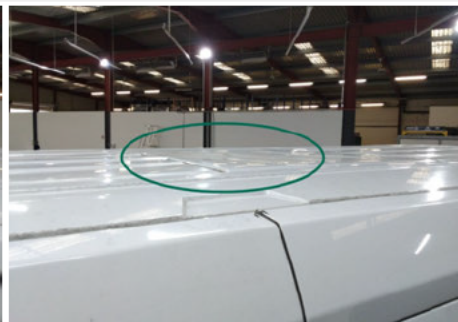
Dach / Hinten / Delle
