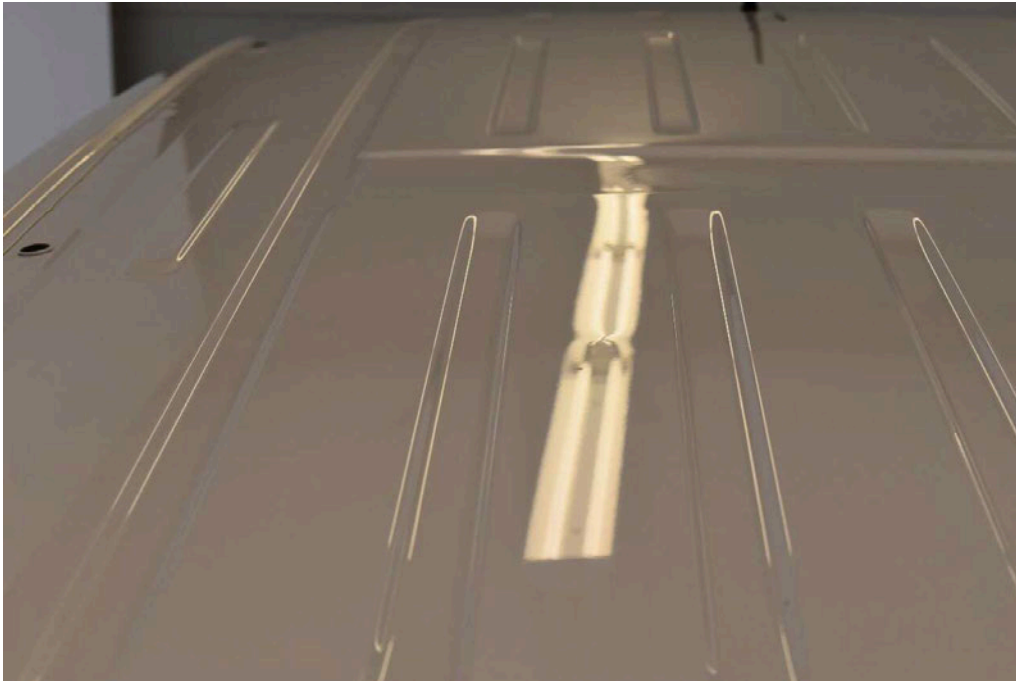
Bild 15 Dach Dachhaut 1 Beule > 20 mm
