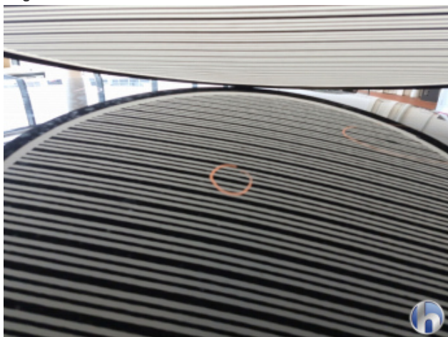
3. Dach Hagelschaden - Siehe Kalkulation
