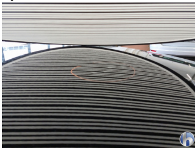
3. Dach Hagelschaden - Siehe Kalkulation
