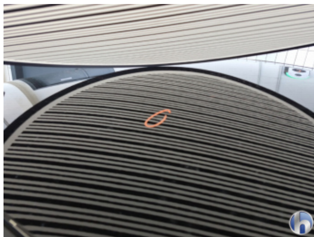
3. Dach Hagelschaden - Siehe Kalkulation
