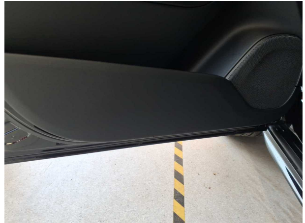
Beschädigung #11: Verkleidungen/Abdeckungen: Türverkleidung vorn links - Kratzer - Smart Repair
