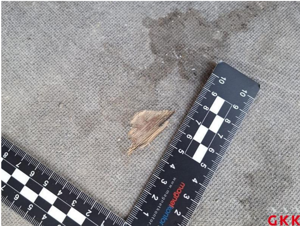
Bild 24. Laderaum, Bodenbelag Holz, beschädigt, ersetzen
