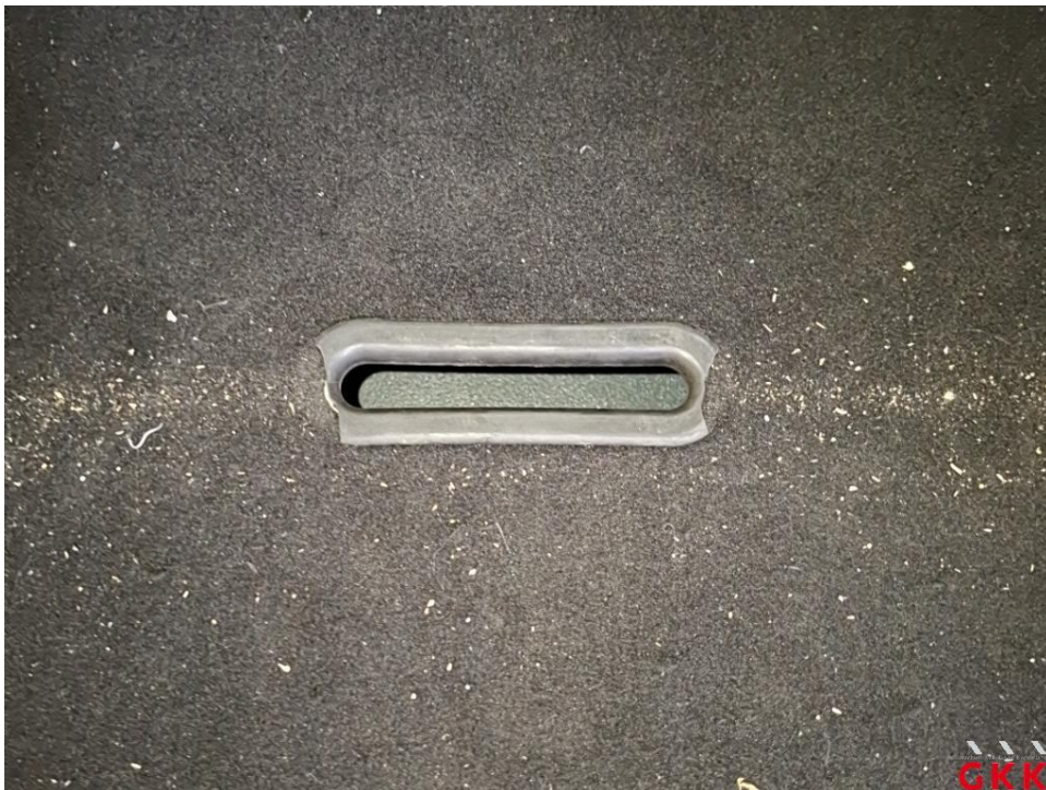
Bild 18 Blende Rampe mitte, beschädigt, ersetzen
