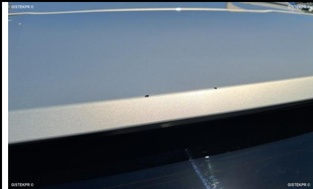
Foto daños externos 1
