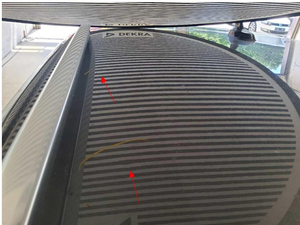
Bild 22 : Dach, mehrfach eingedellt
