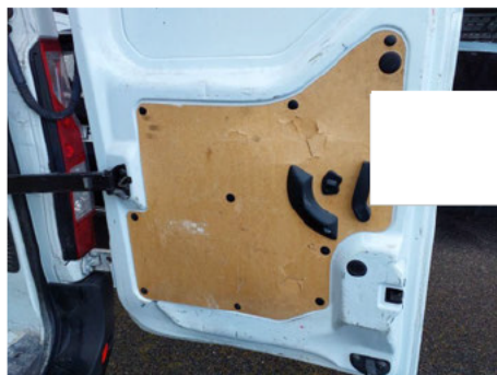
Garniture de porte / Arrière Droit / Cassé
