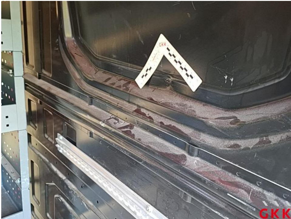
Bild 14. Trennwand, beschädigt, instand setzen - lackieren
