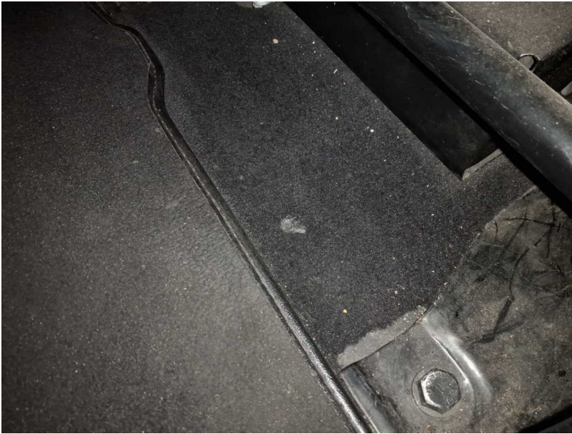
Beschädigung #6: Verkleidungen/Abdeckungen: Teppichboden vorn links - Brandloch - Smart Repair
