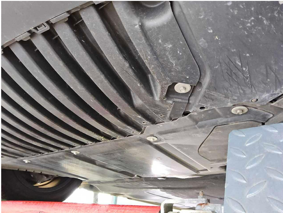
Bild 29 : Unterbodenverkleidung vorne verkratzt, Gebrauchsspur
