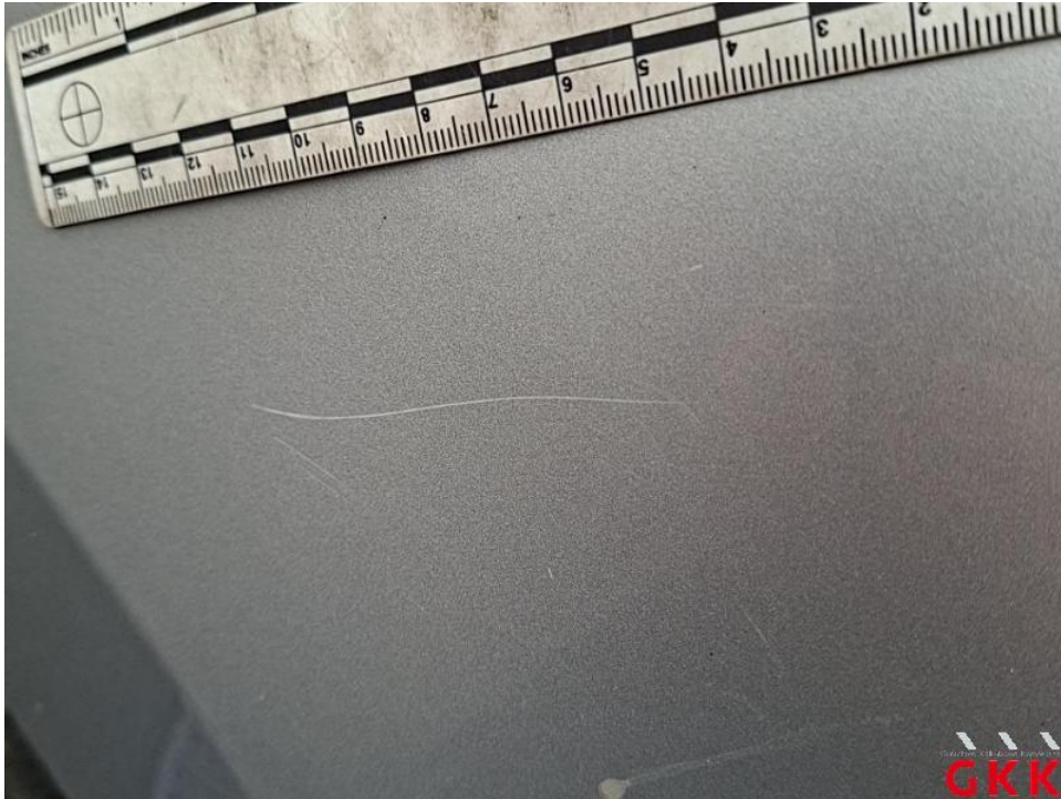
Bild 27. Seitenwand links, beschädigt, instand setzen - lackieren
