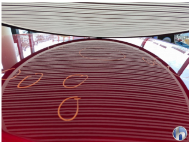
6. Dach Hagelschaden - Sanft Instandsetzen
