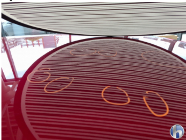
6. Dach Hagelschaden - Sanft Instandsetzen
