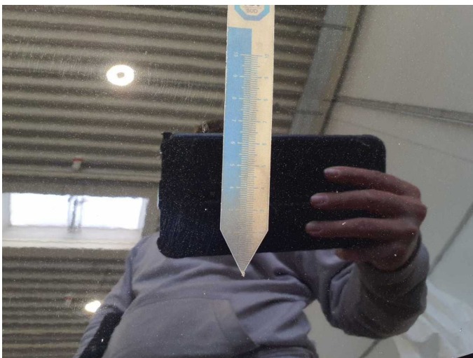
Damage 4: Bonnet: Bonnet (Anätzung) - Paint defect - Paint
