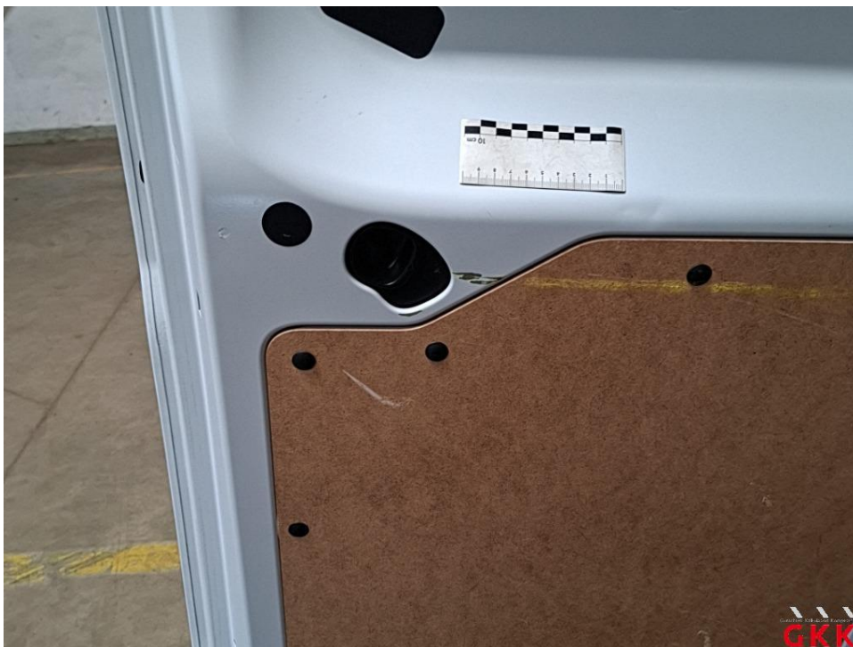
Bild 18 Hecktür links, innen, beschädigt, Smartrepair
