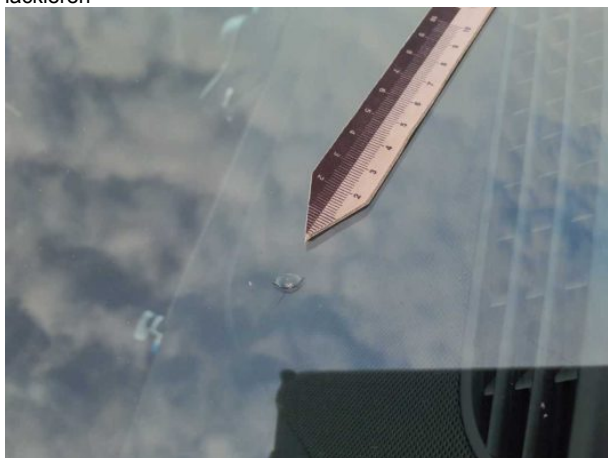
Beschädigung 5: Verglasung: Frontscheibe (Von Carglas bereits ausgeharzt) - gebrochen / gerissen - erneuern
