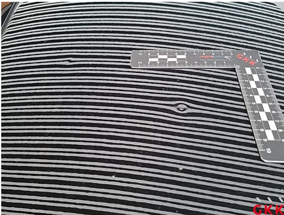
Bild 36. Dach, beschädigt, instand setzen - lackieren
