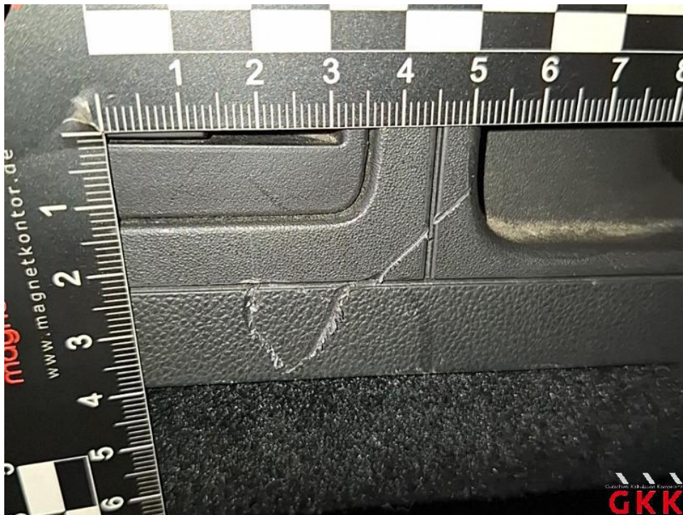
Bild 66. Seitenwand links, Innenverkleidung, beschädigt, ersetzen
