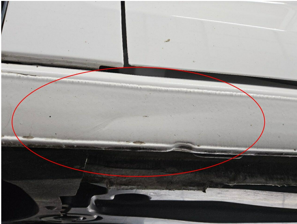
Bild 13 : Schweller vorne links eingedellt
