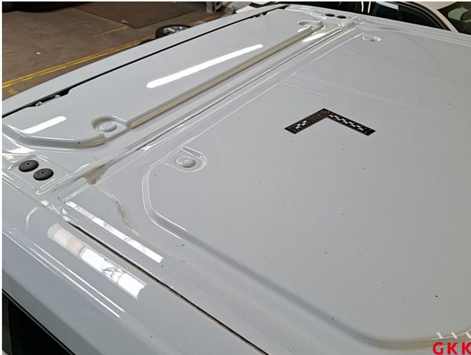
Bild 24 Dach, beschädigt, instand setzen - lackieren
