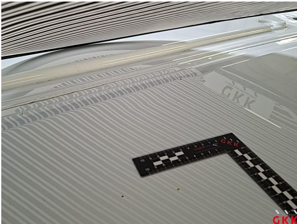
Bild 25 Dach, beschädigt, instand setzen - lackieren
