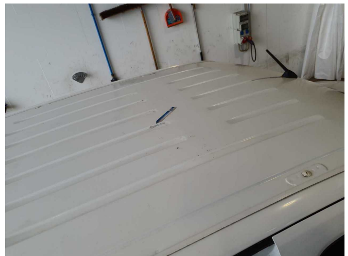
Damage 7: Roof: Roof (Lack löst sich ab, zusätzlich Korrosion) - Paint defect - Repair and paint
