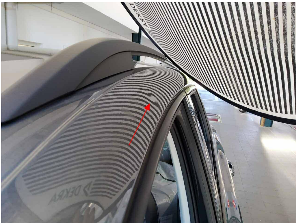
Bild 22 : Dachrahmen links, eingedellt
