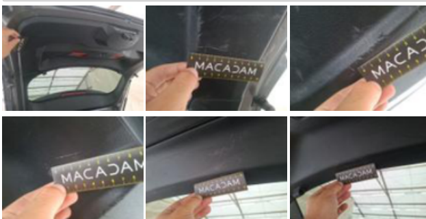
Joint de coffre, Déchirure, E - Remplacer
