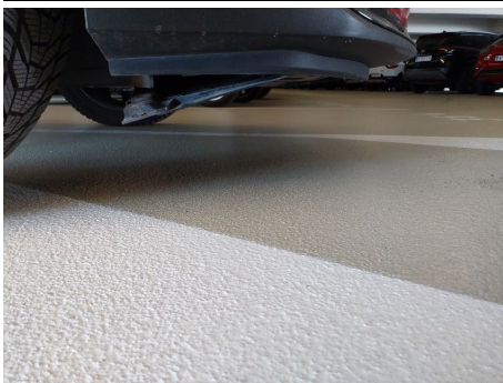
Unterfahrschutz / Vorne / Gebrochen
