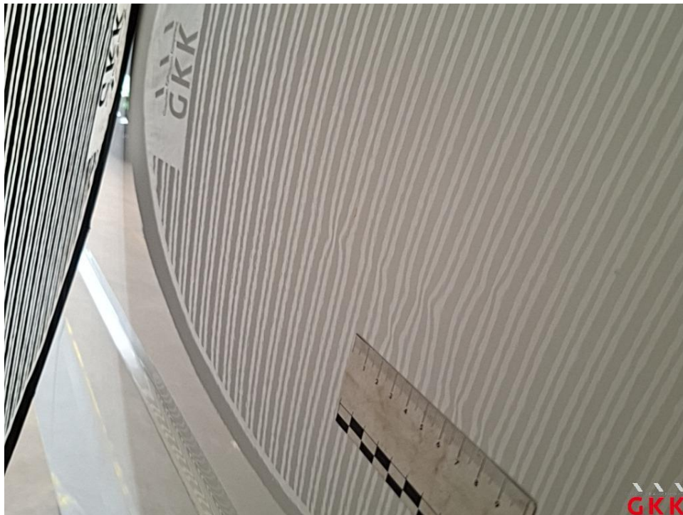
Bild 32 Schiebetür rechts, beschädigt, instand setzen - lackieren
