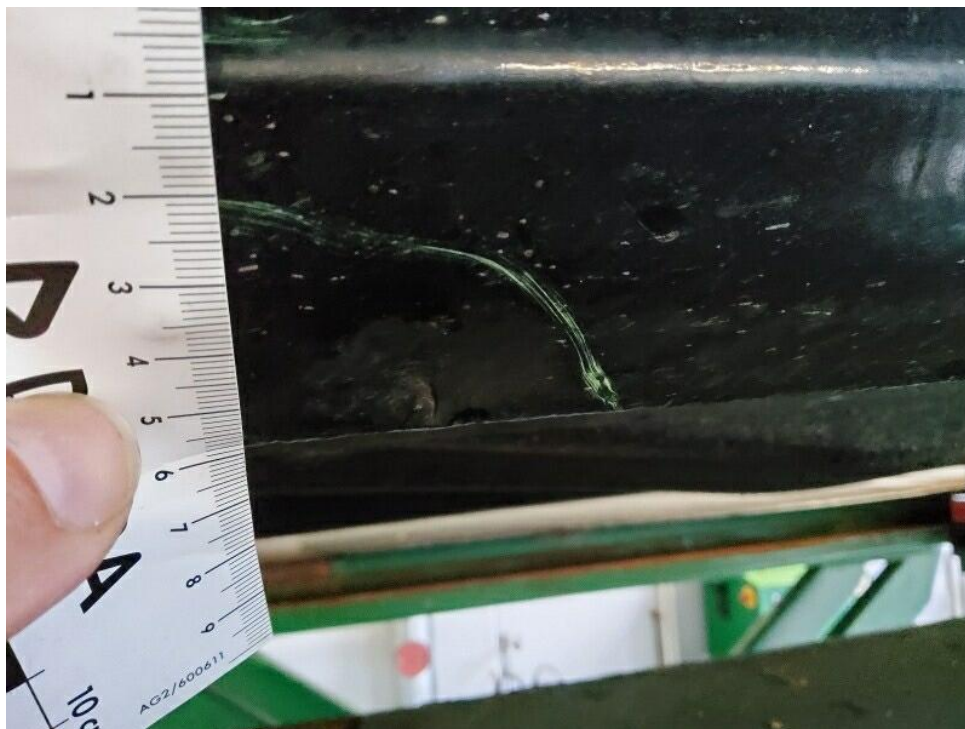
Bild 47 : Außenschweller vorne links mehrfach leicht eingedrückt
