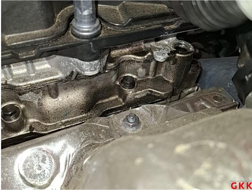
Bild 17 Motor, Öl undicht, prüfen
