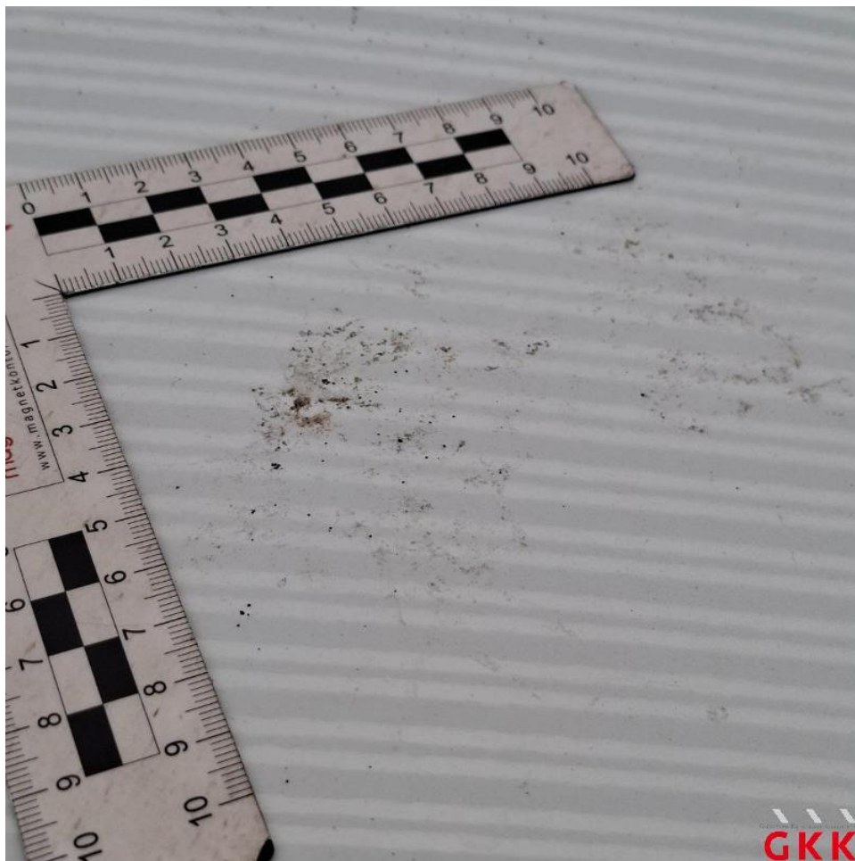
Bild 62. Dach, Lackierung verätzt, lackieren
