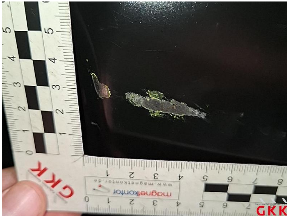
Bild 59. Trennwand, beschädigt, lackieren
