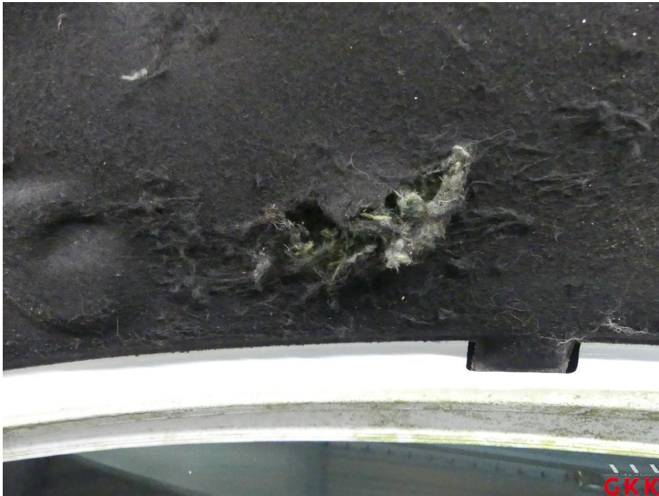
Bild 15 Motorhaube, Dämmmatte, beschädigt, ersetzen
