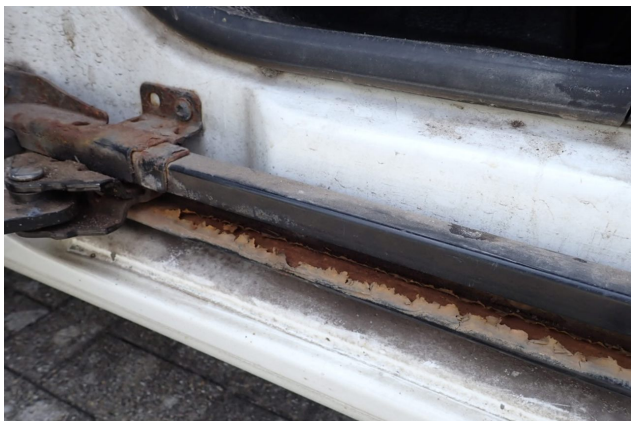
Beschädigung 3: Schiebetür rechts: Führungsschiene - Korrosion - kein Abzug
