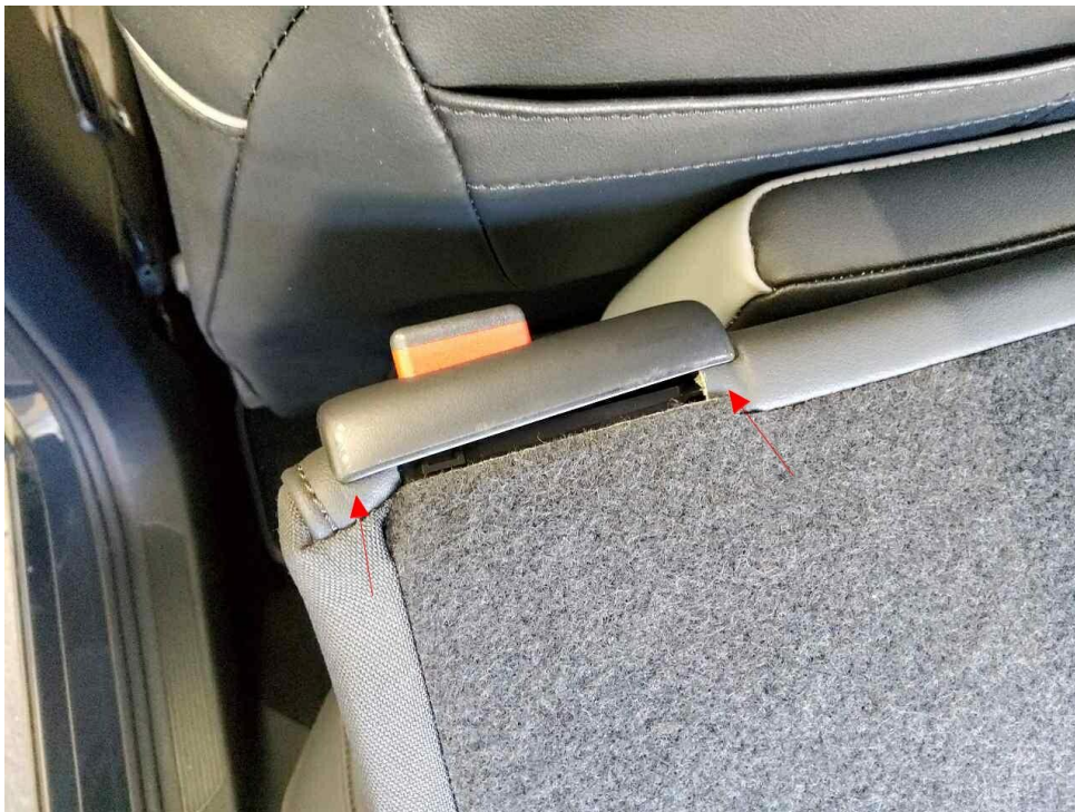
Bild 30 : Abdeckung Lehnenentriegelung links abgelöst
