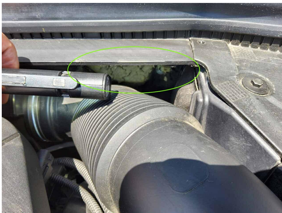
Bild 14 : Dämmung Stirnwand Tierverbiss
