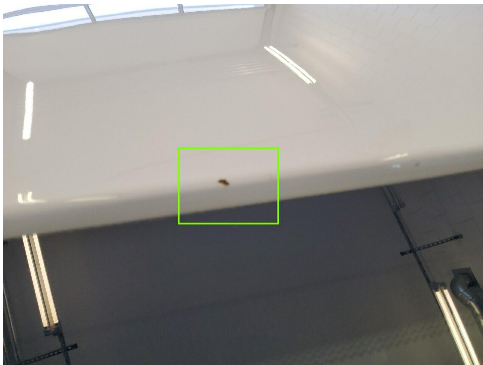
Bild 19 : Steinschlag an der Dachkante
