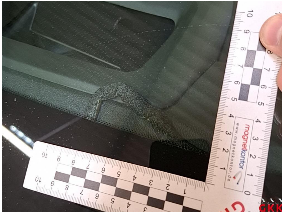
Bild 19 Armaturenbrett, Dichtband fehlposition, instand setzen
