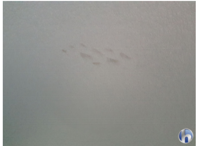
9. Dachhimmel Verschmutzt - Reinigen
