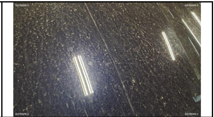
Foto daños externos 1
