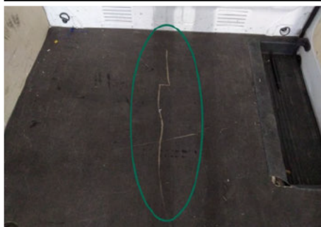
Holzboden / Hinten / Kratzer
