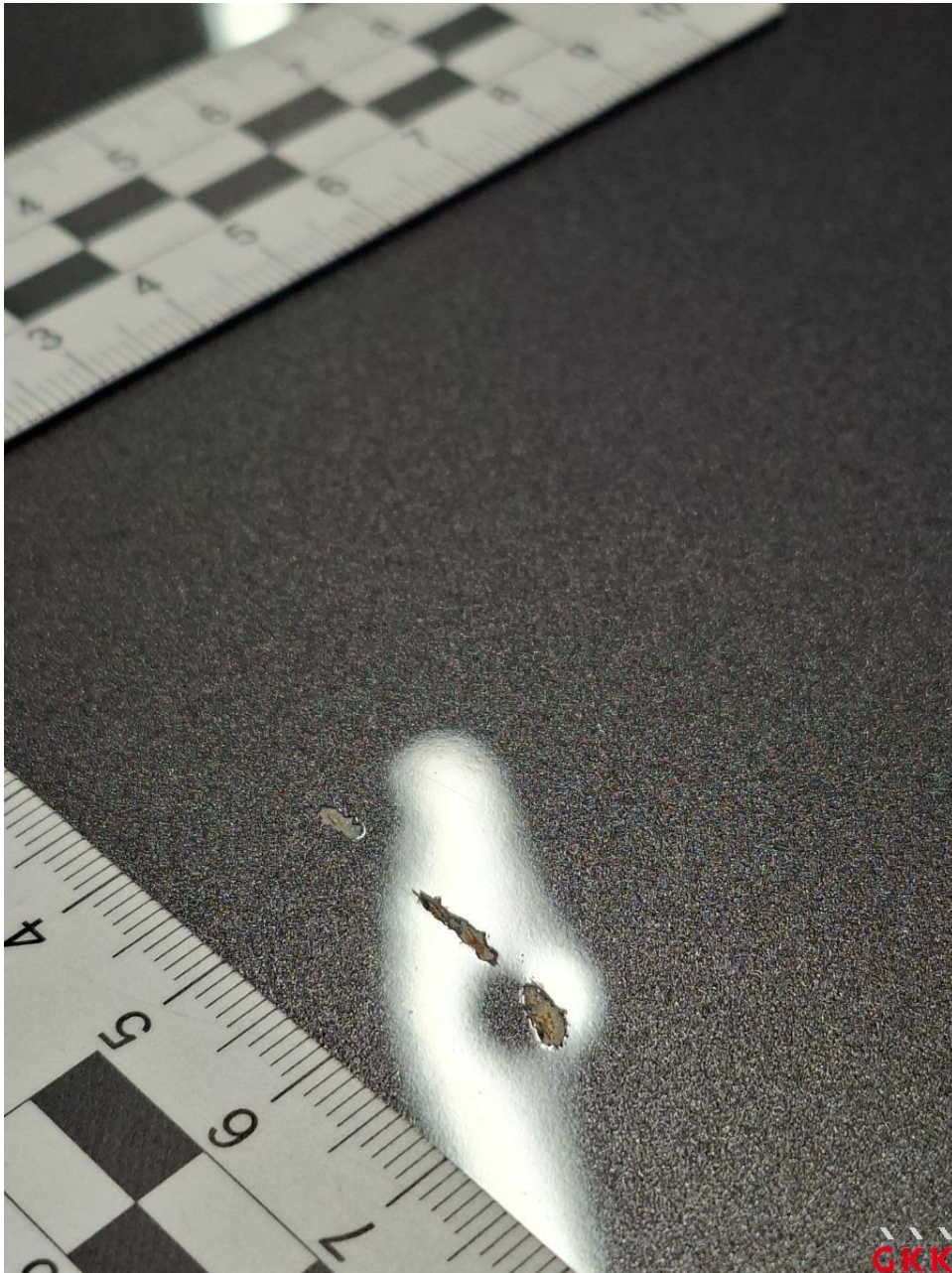
Bild 23 Dach, beschädigt, instand setzen - lackieren
