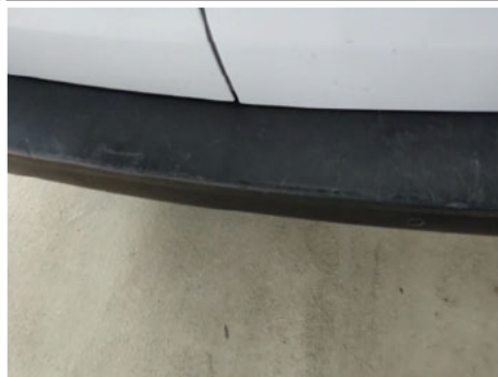
Stoßfänger / Hinten / Gebrochen
