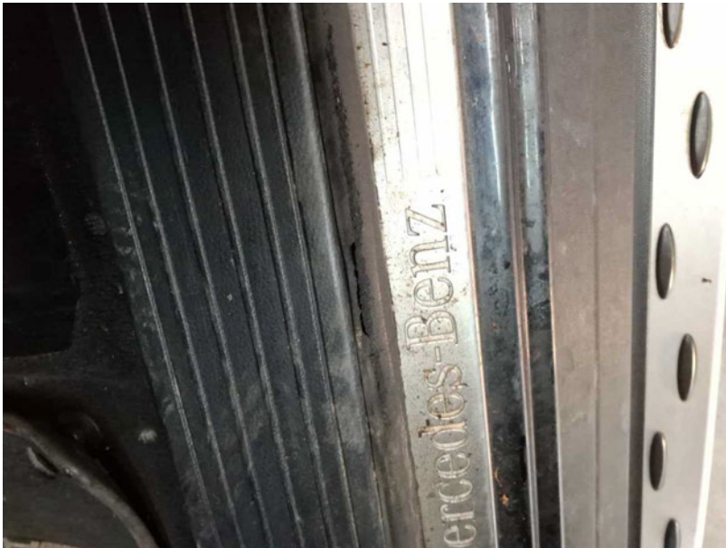
Beschädigung #8: Tür vorn links: Türdichtung - gebrochen / gerissen - erneuern
