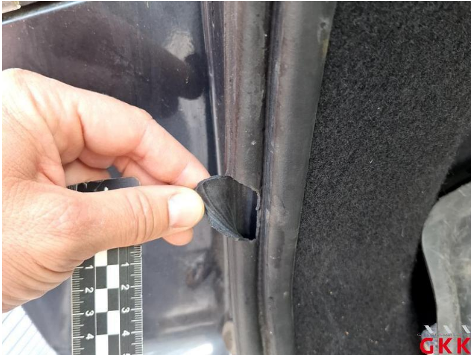
Bild 33. Laderaum, Dichtung, gerissen, ersetzen
