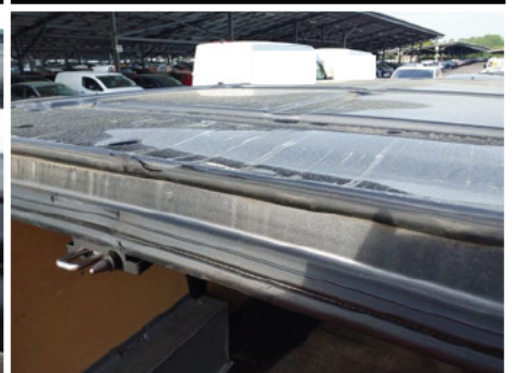
Joint de porte / Arrière / Déchiré
