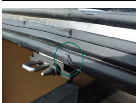
Joint d'entrée de porte / Arrière / Déchiré
