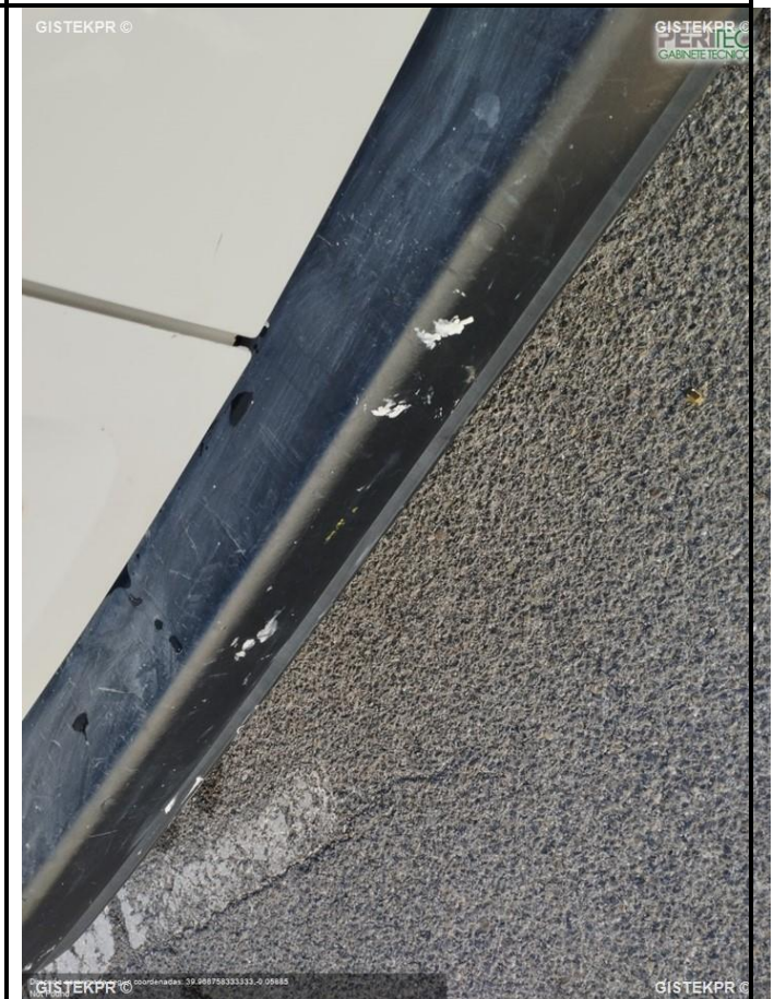
Foto daños externos 1
