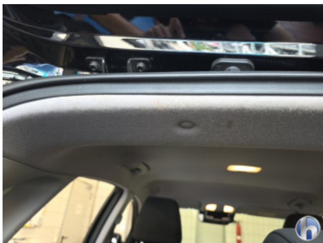
2. Dachhimmel Fleck - Reinigen
