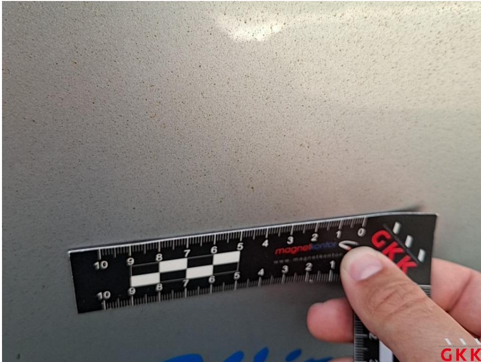
Bild 27. Tür vorne rechts, Lackierung verwittert / matt, polieren
