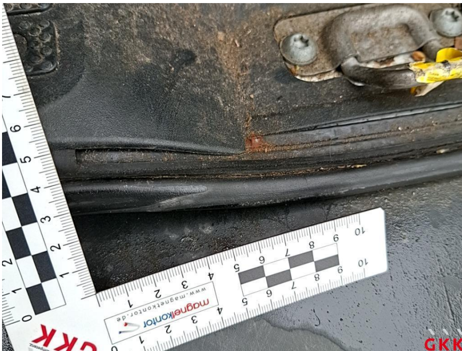
Bild 50 Laderaum, Dichtung, beschädigt, ersetzen
