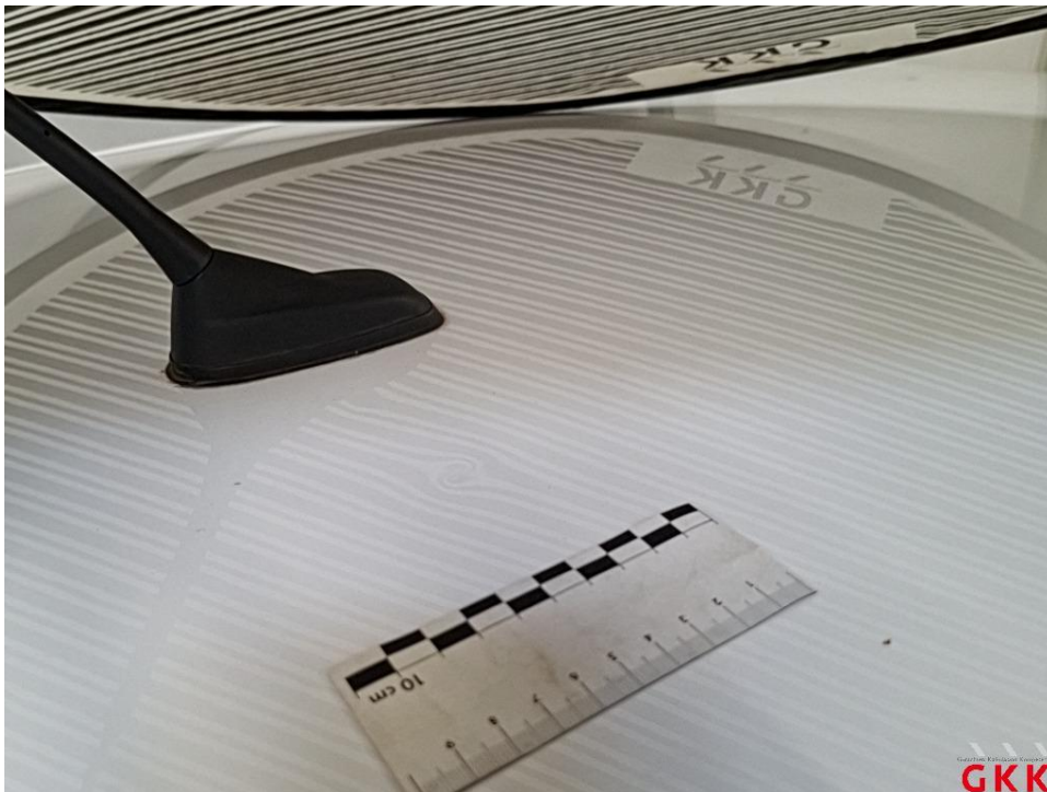
Bild 40 Dach, beschädigt, kalt drücken
