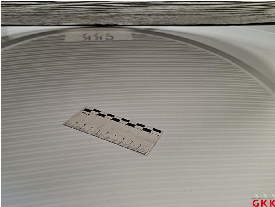
Bild 41 Dach, beschädigt, kalt drücken
