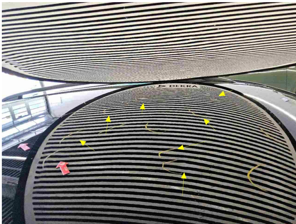
Bild 22 : Hagelschaden, Dach 98, Rahmen rechts 4, Türe hinten rechts 1,
